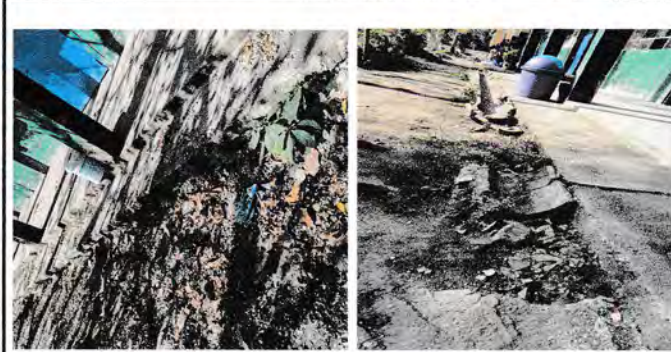
Foto 4: Banqueta socabada, frente a los salones de primero, segundo y tercer grado Sección A. Lo cual es un riesgo para la infraestructura por el socabamiento en temporada de lluvia.
