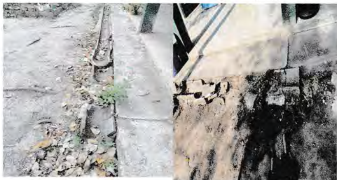
Foto 3: Cuneta en mal estado de frente a los salones y por la parte de atrás de los mismos. Por tal razón se desborda las corrientes de aguas pluviales. Afectando la infraestructura de la banqueta.
