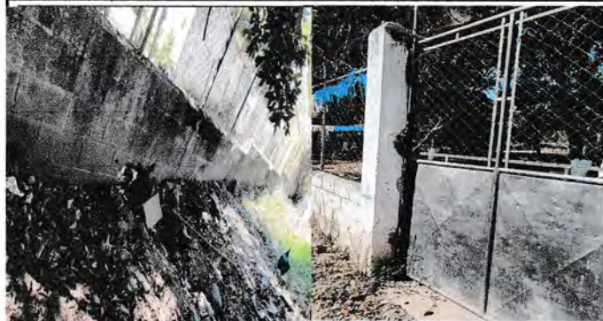
Foto1: Muro perimetra se esta socabando, además las columnas se encuentran dañadas. También la malla se encuentra en gran parte rota, tomando en cuenta que lleva 20 años. Por lo tanto no hay seguridad para los estudiantes.
