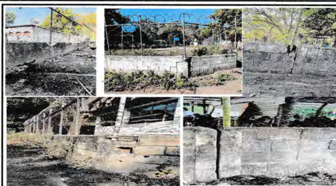
Foto 2: Muro perimetral rajado por el paso de los años. Se encuentra a punto de desplome, facilitando el ingreso a personas ajenas al centro educativo.
